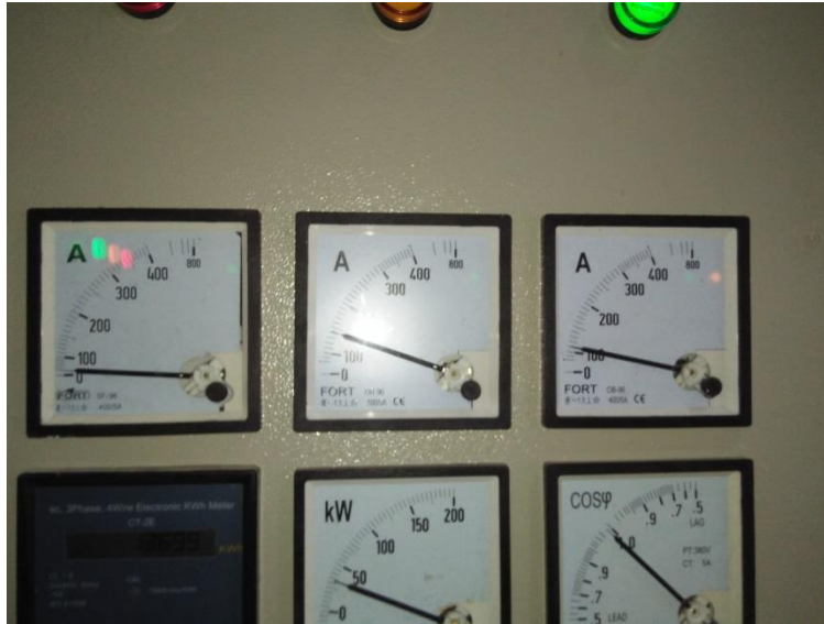
Gambar 4.49 Power Factor pada Panel Gedung A ITK
