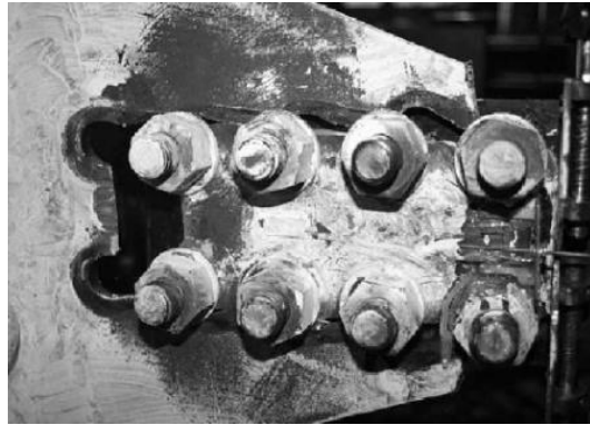
Gambar 2. 16 Keruntuhan geser blok pada struktur baja
