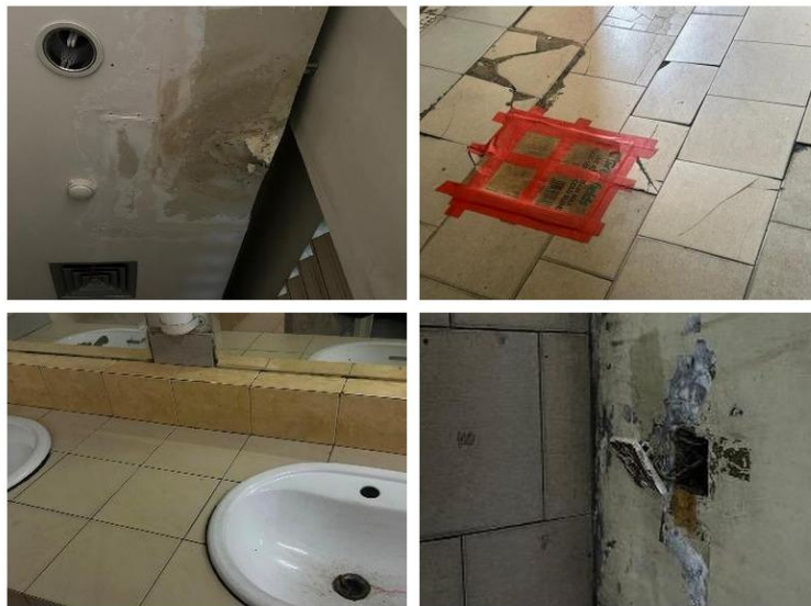
Gambar 1. Kondisi Kerusakan Komponen Gedung Plaza Kebun Sayur (Sumber: Penulis, 2026)
